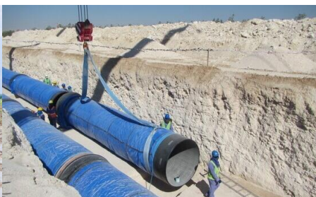
■ 水：カタル 約480kmの水道管
