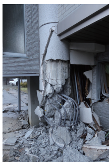
写真 1 せん断破壊した鉄筋コンクリート造柱 鉄筋コンクリート造柱のせん断破壊は急激に耐力を失ってしまう脆い破壊形式であるため、避けるべきものとされています。
