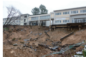
写真 3 崩落した地盤 地盤が崩落しても、基礎構造がしっかりと設計・施工されていて、建物がしっかりと支えられていたため、上部の建物に傾きや損傷は生じなかったと考えられます。
