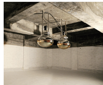
図 2 チベットの宇宙線・宇宙ガンマ線観測装置の地下 2m に設置された 3,400m 2 のミューオン検出器の一部。スーパーカミオカンデ実験と同様に水チェレンコフ型で、光センサーとして 20 インチ光電子増倍管を用いている。Tibet AS γ 実験グループ提供。
